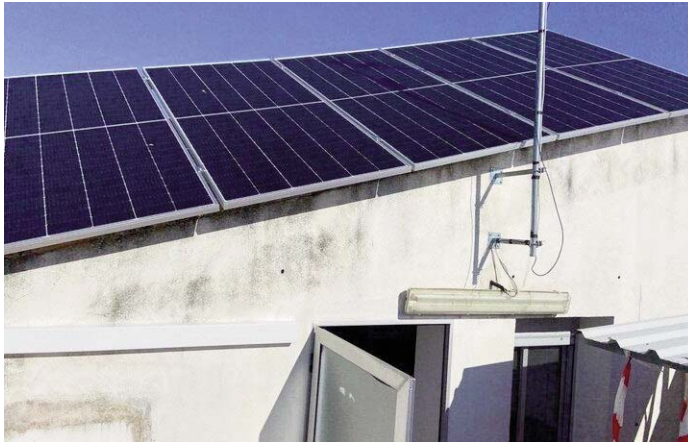
Placa solar en un inmueble de Villanueva de la Reina. AYUNTAMIENTO
